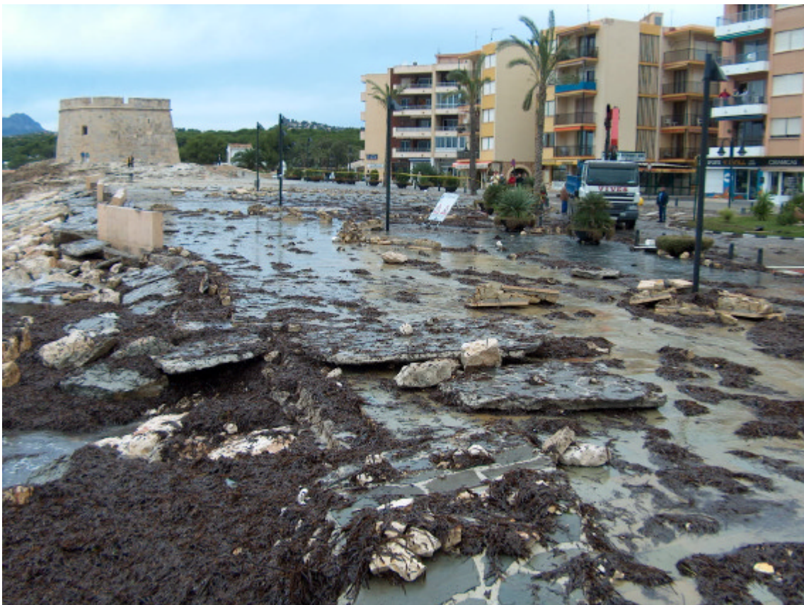
Figura 32. Efectos del temporal en las estructuras costeras de la población de Moraira.
