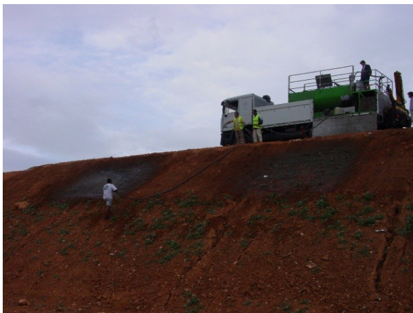
Fotografía 7.1. Hidrosiembras llevadas a cabo en los terraplenes de la variante de Utiel de la N-330 utilizando la maquinaria de obras públicas.
