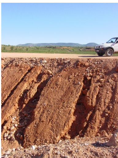
Fotografía 1.2. Efectos de la erosión tres meses después de la construcción de los taludes en la variante de Utiel de la carretera N-330.
