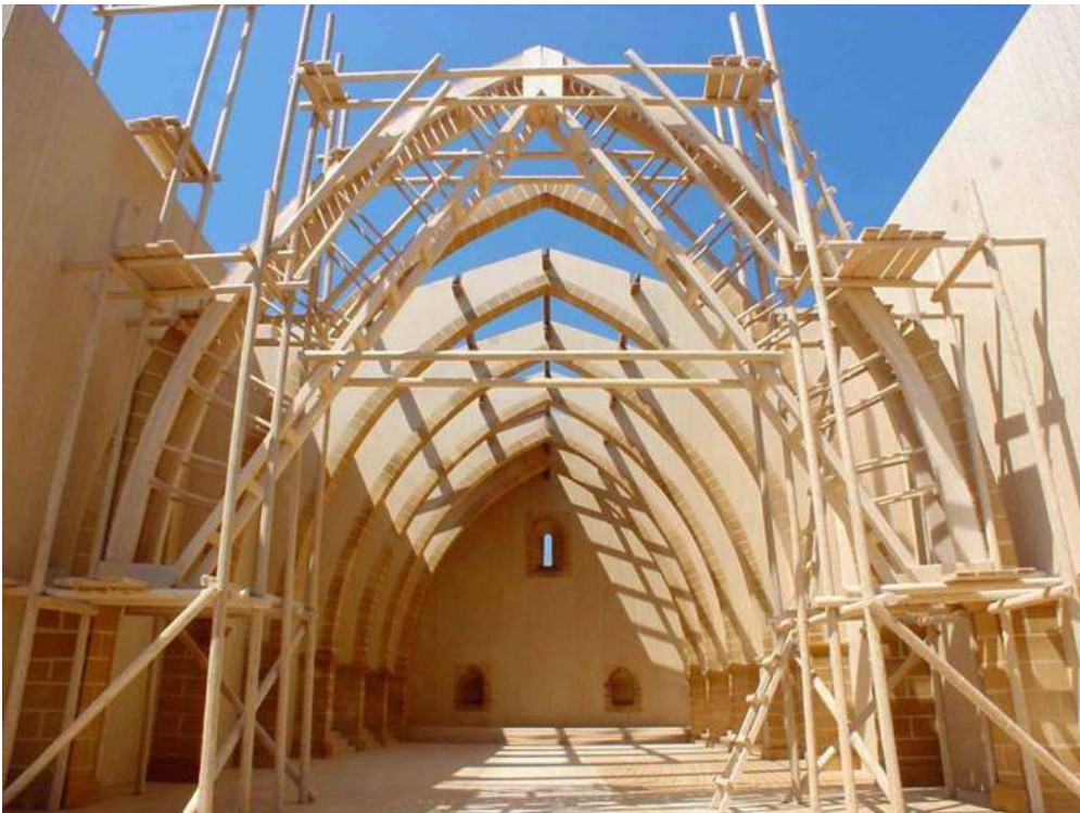
Figura 53. Maqueta de l'església d'Olocau del Rei en construcció, segons el contracte de 1296
