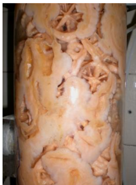
Figura 2.6. Obturació d'un biofiltre percolador per acumulació excessiva de biomassa.
