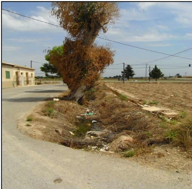
Fotografía 4. Canal con aguas residuales (Dolores, 2008).
