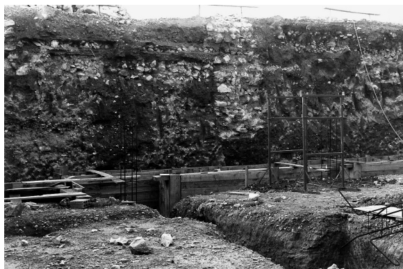
Fig. 6. Fotografía en la que se puede observar la estratigrafía del cerro de la Zuda, durante las obras del Parador Nacional de Turismo (fotos de R. Miravall, a quién agradecemos la gentileza de su cesión).
