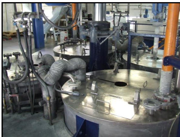
Fig. 5.3: Tanques de mezcla y dispersión de 5 m 3 utilizados en la planta
