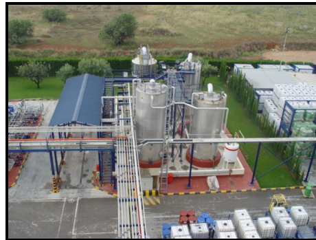
Fig. 1.8: Parque de tanques PT 30
