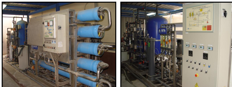
Fig. 1.10: Planta de ósmosis inversa
