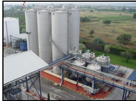
Fig. 1.9: Parque de tanques PT 34
