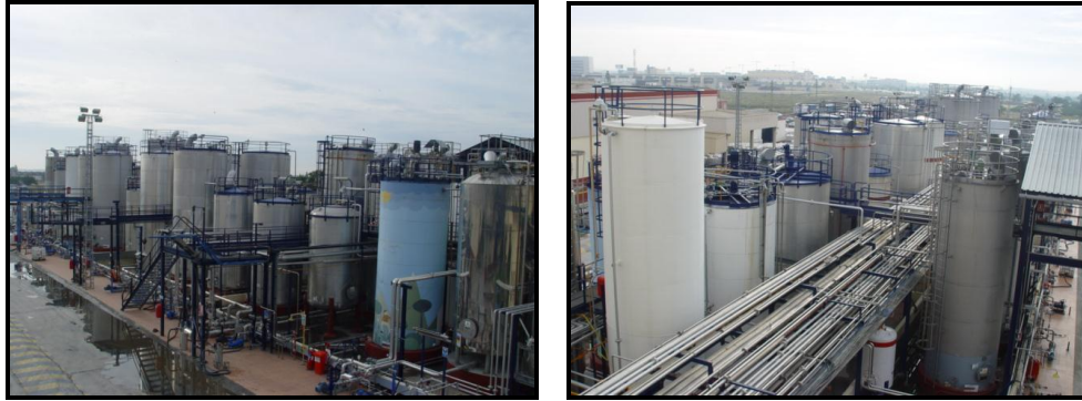
Fig. 1.7: Parque de tanques PT 29
