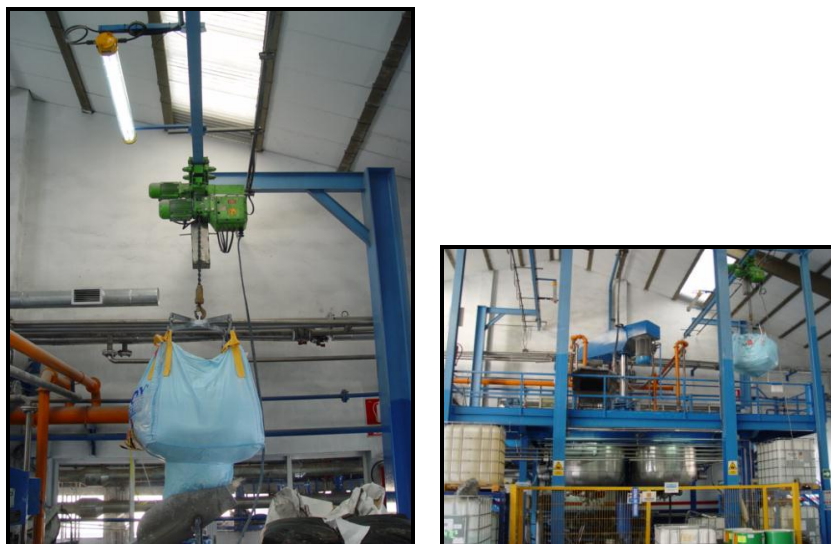
Fig. 5.23: Proceso de descarga de Big-bags a los cuatro tanques
