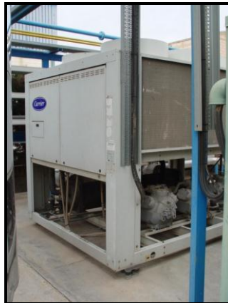
Fig. 5.17: Chasis de la instalación del grupo de frío
