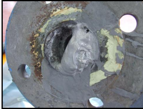
Fig. 2.1: Estado de una tubería por donde ha pasado el producto
