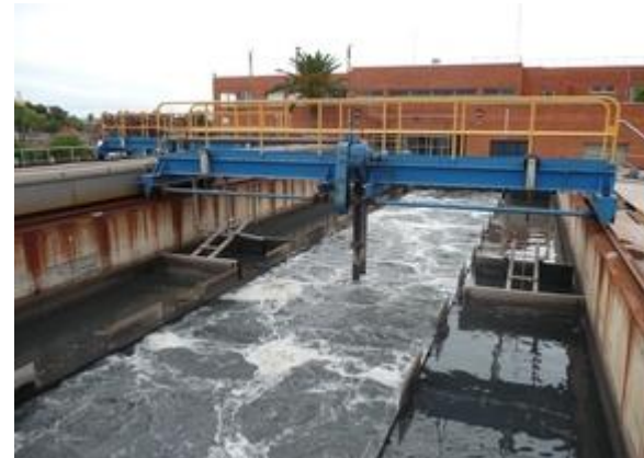
Depuradora d'aigües residuals
