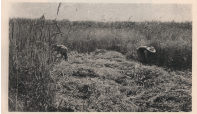
Realizadas las obras de defensa, se procede a rozar la extraordinaria vegetación espontánea. Foto Arrúe.
