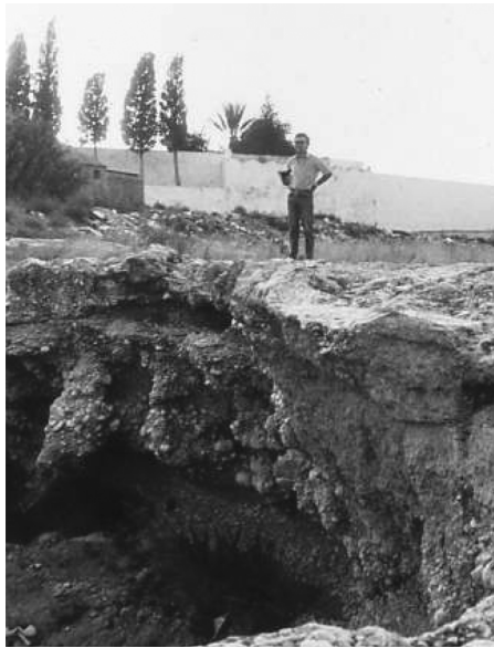
Foto 4. Els esglaons que de vegades es formen als llits de les rambles disminueixen la capacitat de la secció transversal i són punts de desbordament. En la foto esglaó format a la Rambla de Cervera, prop de Benicarló.
