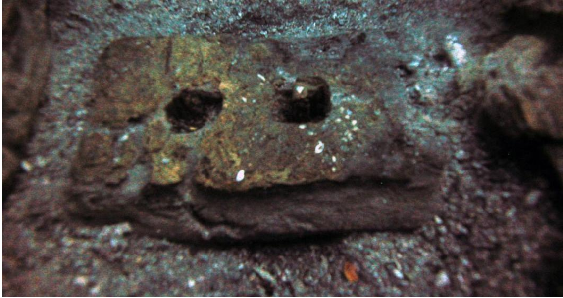
Fig. 249.- Vista de un par de cabillas que sobresalen y que no presentan una regata de unión para la protección de la ligadura, que ha desaparecido. (Autor: CASC).
