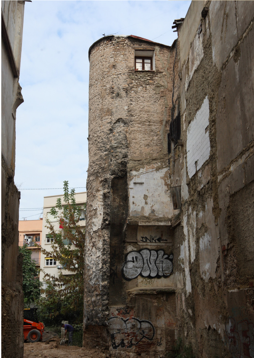
La destrucción de la muralla permite observar algunos de los últimos vestigios de la presencia árabe, frecuentemente ignorada (Torre del Ángel).
