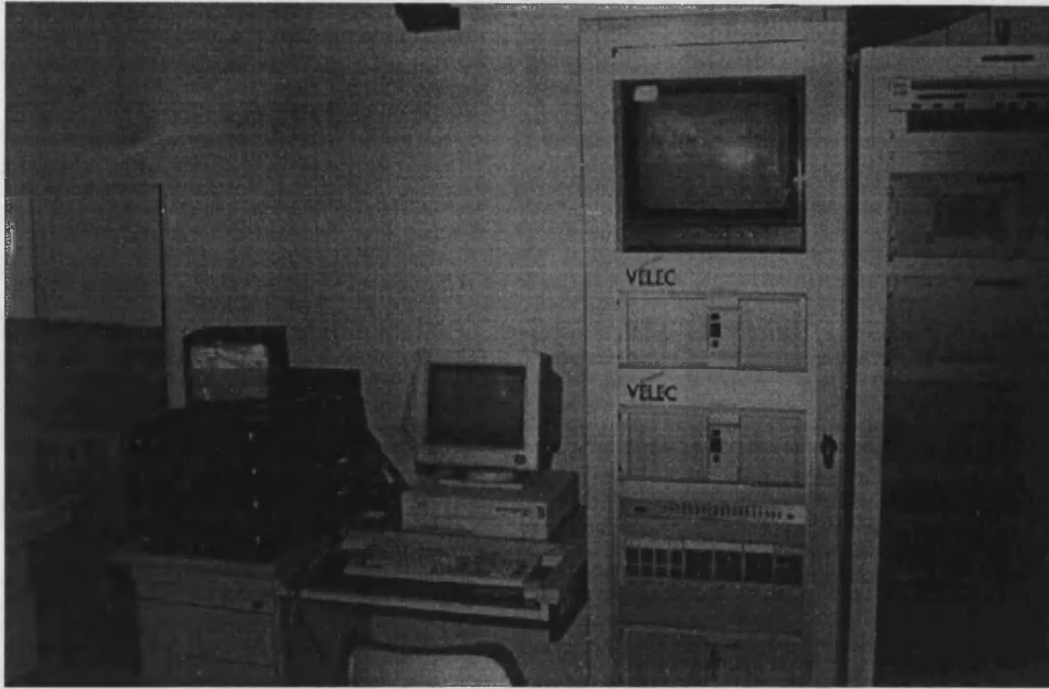
Figura 11.- MLPs y SCC en la sala de equipos de Lion.
