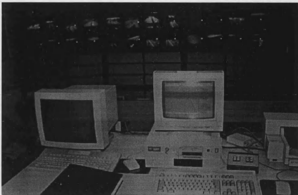
Figura 7.- Instalación del SCP remoto en el centro de control de Amberes
