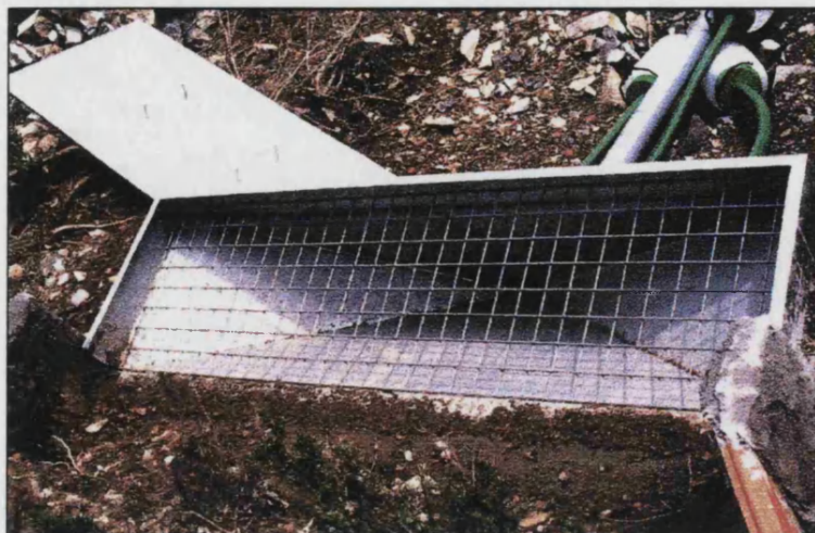
Detalle del sistema colector de sedimentos y escorrentía
