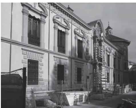
Bajantes de cobre adosadas a la fachada. Palacio de Bibataubín de Granada.
