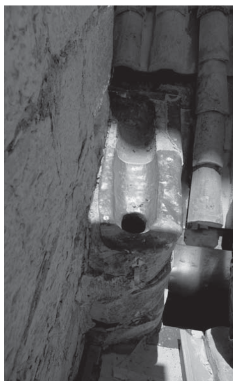
Forrado de plomo de la entrada de una bajante oculta paralela a un contrafuerte. Catedral de Jaén.
