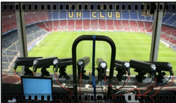
(Sistema de cámaras de seguimiento y monitorización instalado por la empresa Delta Tre en el Camp Nou.
