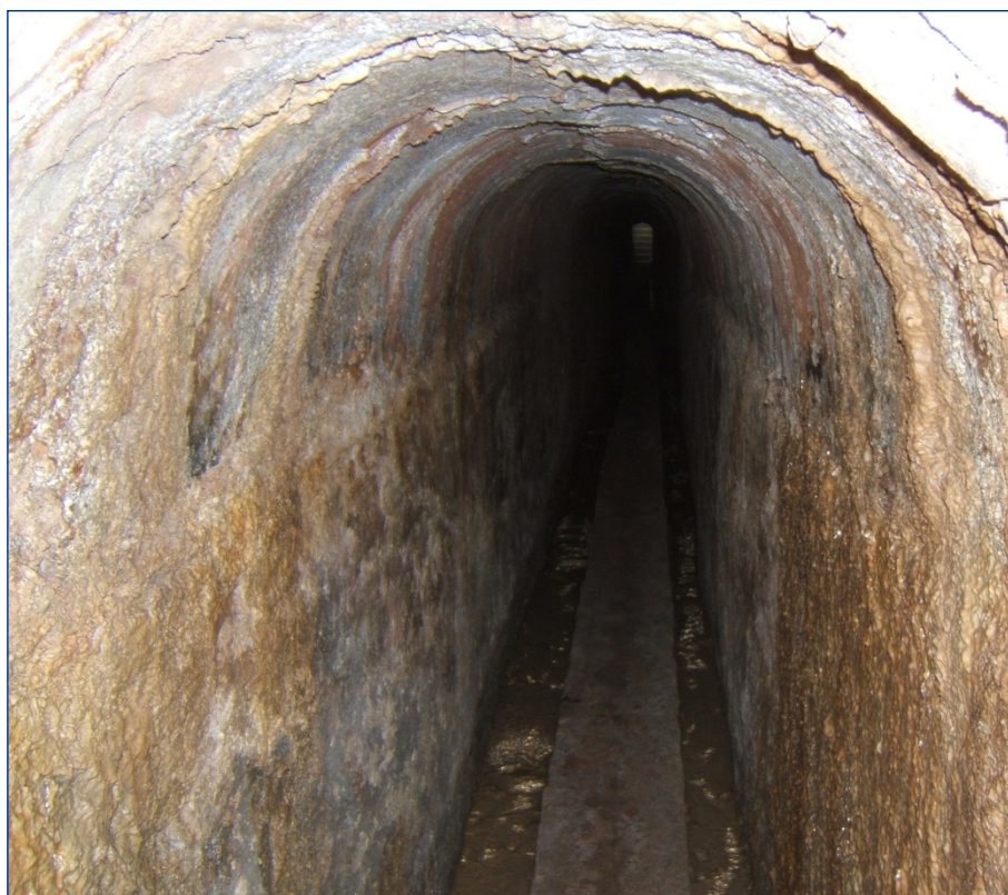
Foto 5. Interior de la captación de la Font del Comte (Algimia de Alfara, Valencia).
