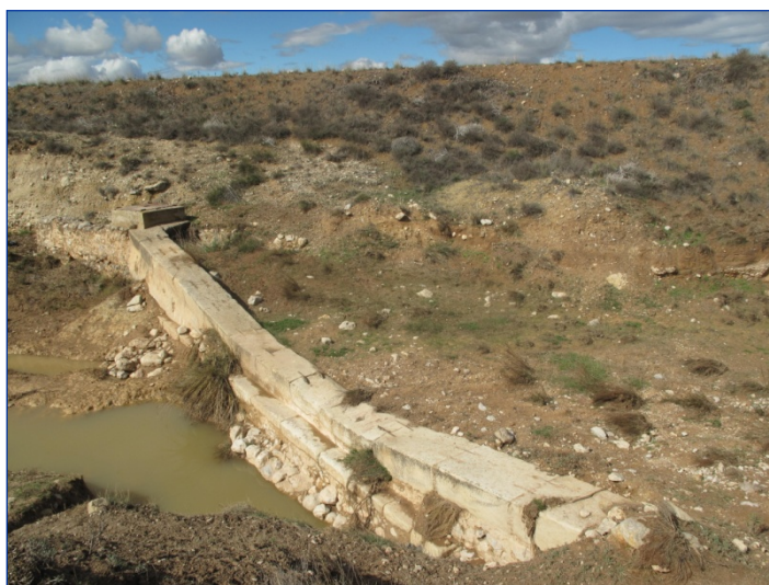
Foto 20. Cruce de la galería de los Pozos de la Fuente por la rambla de Avilés (Lorca, Murcia).
