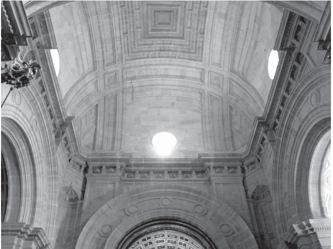
Fig. 3. Interior de la capilla mayor de la iglesia de Santiago de Orihuela.
