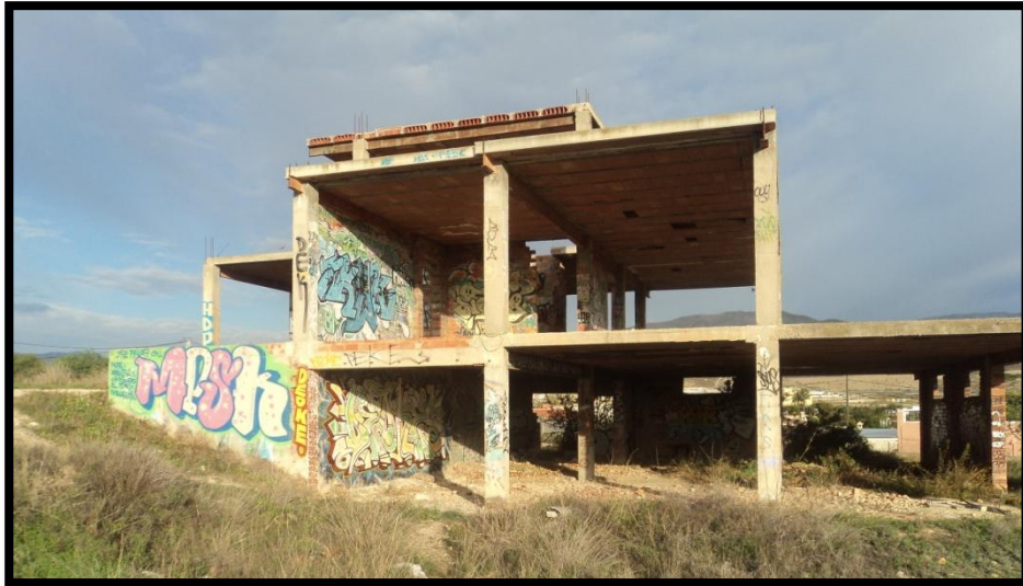
Img.: 73 Estructura abandonada. Vilajoiosa Alacant 2012. Fot.: BG
