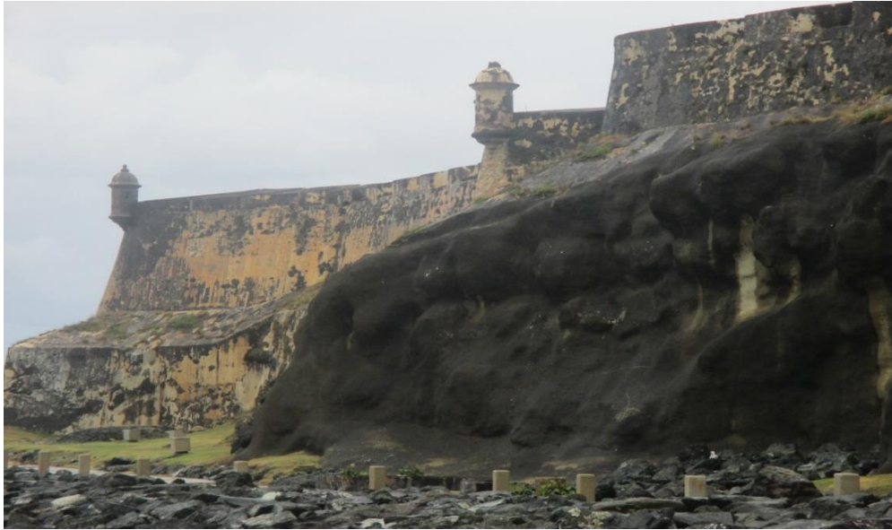
2.12 PARA CONTENER LA EROSIÓN DESDE 1949 SE COMENZÓ A CONSTRUIR EL ROMPEOLAS Y SE ROCÍA CON UNA CAPA DE HORMIGÓN “SHOTCRETE”.
