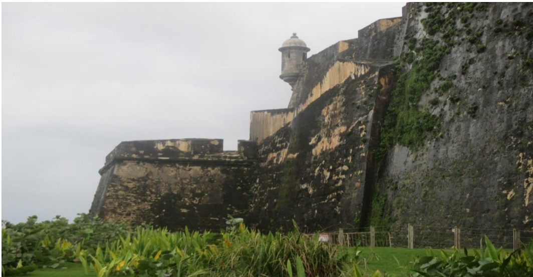
2.13 ENTRE LAS PEQUEÑAS POROSIDADES Y ABERTURAS CRECEN PLANTAS QUE DESTRUYEN LOS MUROS.
