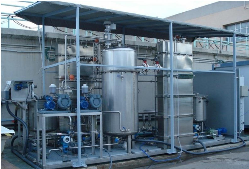
Figura 46. Vista general de la planta SAnMBR.
