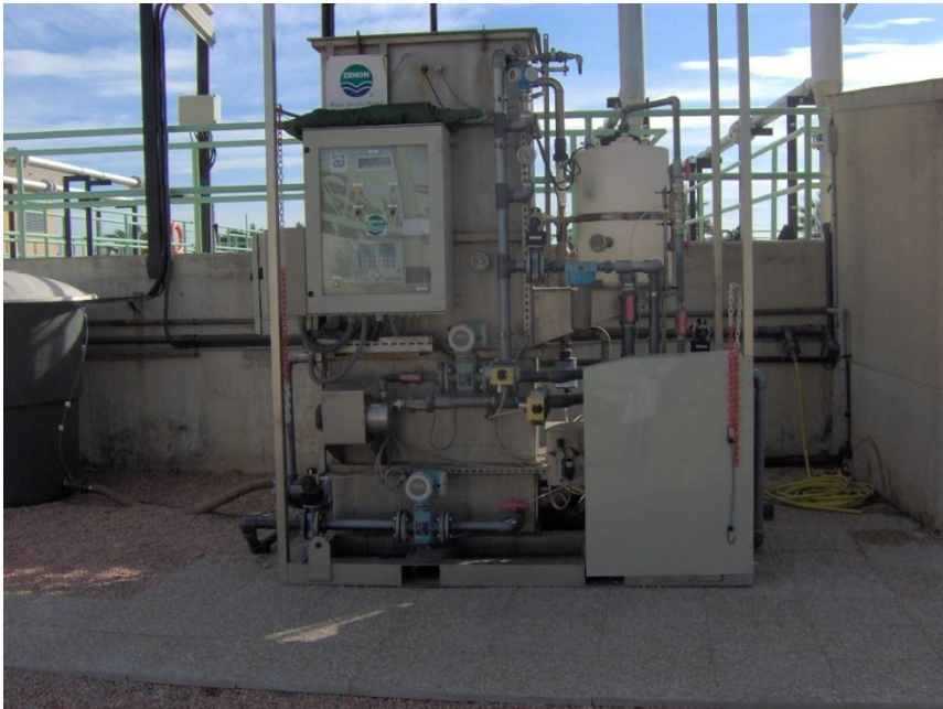
Figura 47. Vista general de la planta piloto aMBR.
