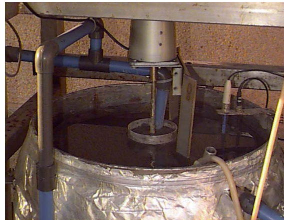
Figura 5.5. Vista superior del decantador primari amb la rasqueta instal·lada i les sondes de pH i temperatura
