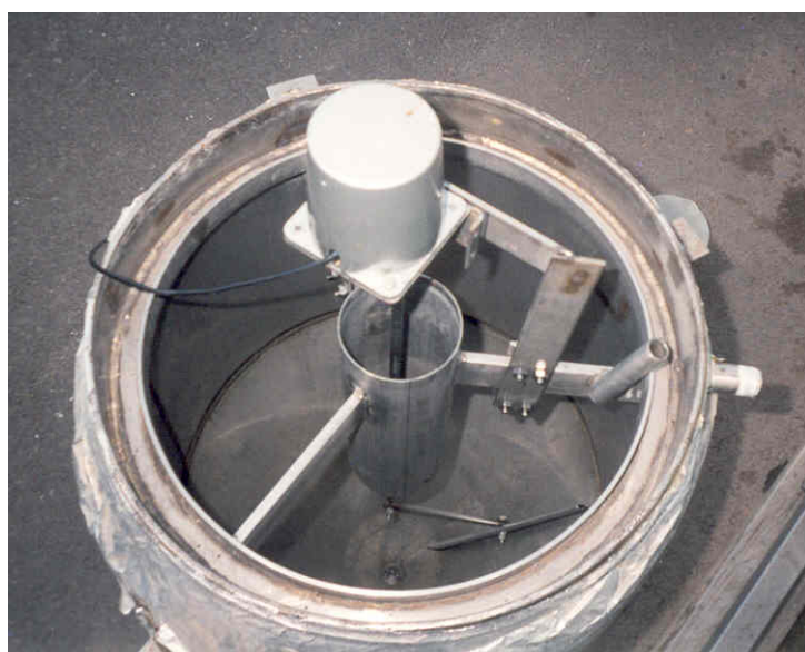
Figura 10.4. Detall del rascador de fons instal·lat al decantador primari.
