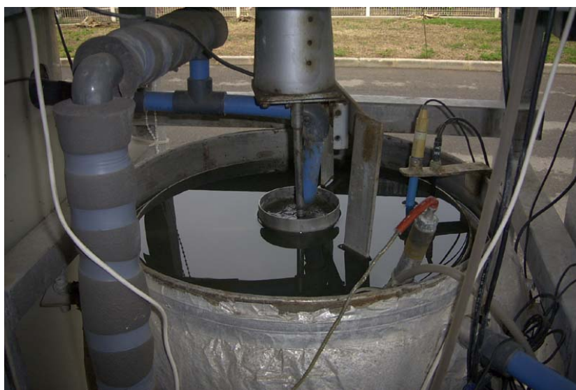
Figura 10.2. Efluent del decantador amb les sondes de pH i Temperatura instal·lades.
