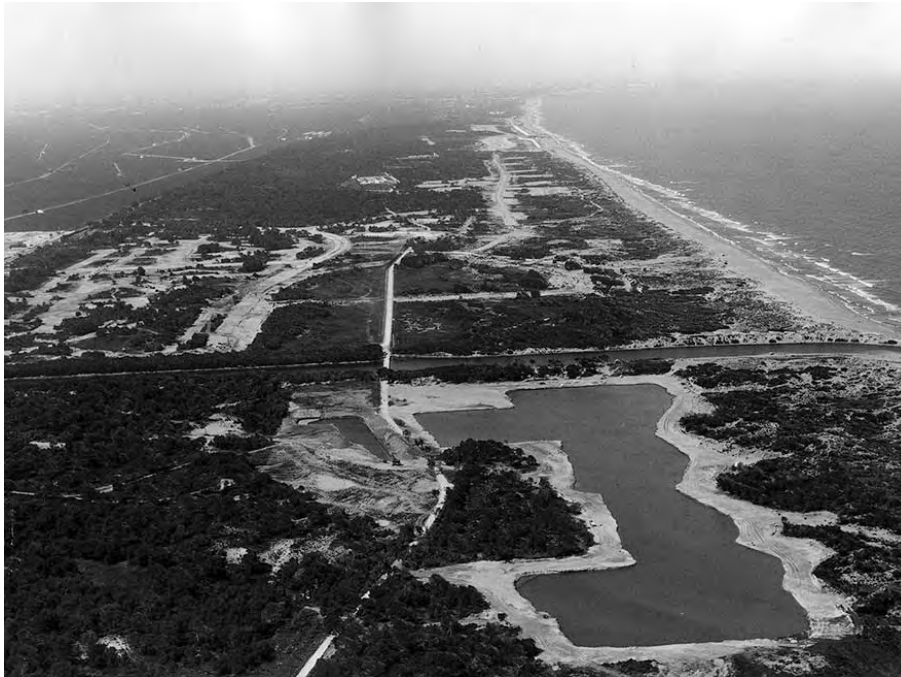
Figura 13. Fotografía aérea realizada el día 6 de agosto de 1970. Se observan diferentes zonas de actuación con la construcción en curso del lago artificial en primer plano junto a la Gola de Pujol. (Fotografía cedida por el Servicio Devesa Albufera, Ayuntamiento de Valencia).
