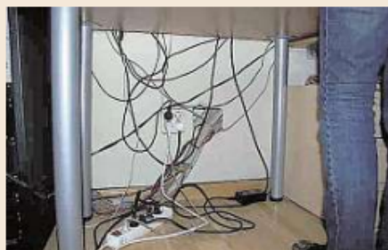
Aspecto de una conexión eléctrica
