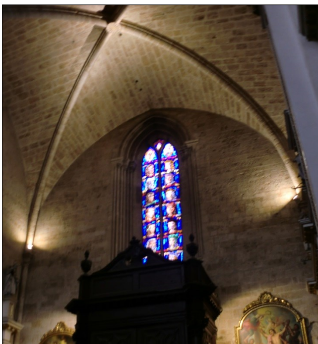
Fig. 7. Vista de bóveda y ventanal, crucero de la Epístola, tras la portada de la Almoína.
