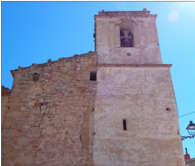
Fig.3. Detalle de la fachada SO de la nave primitiva donde se aprecia un canal de desagüe y un ventanal de medio punto cortado por la torre construida en el siglo XIX.
