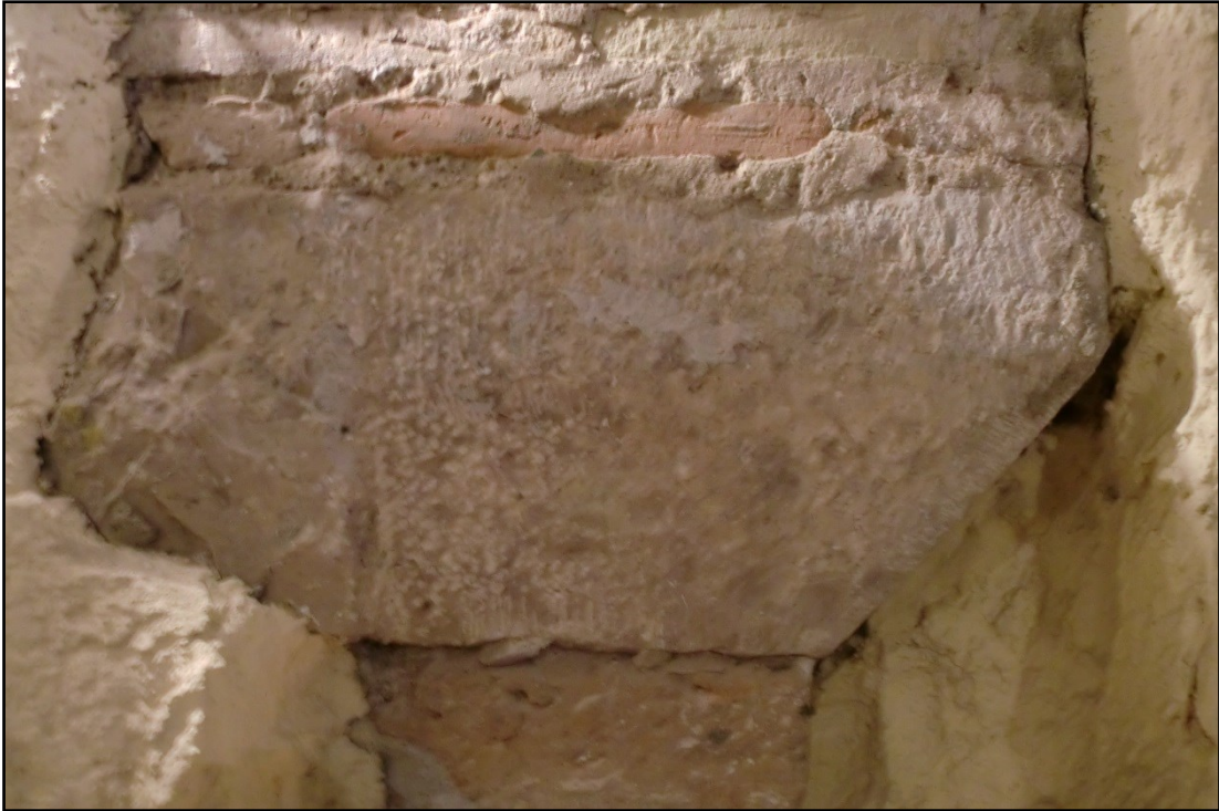
Fig. 3. Vista frontal de la imposta desde la que arranca el arco de ladrillo.
