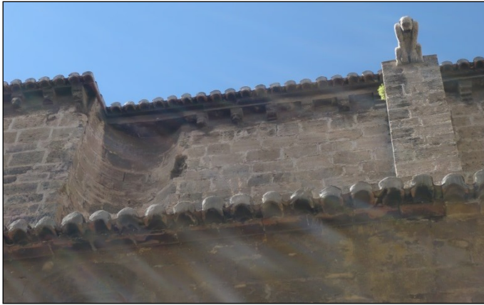
Fig. 3. Fachada norte. Resto de la escalera de caracol y ampliación de la nave hacia el oeste.
