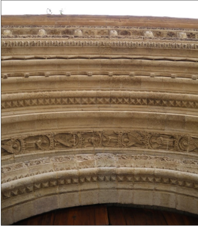
Fig. 14 Detalle de las arquivoltas de la portada del Palau, con la recomposición de las dovelas del arco.
