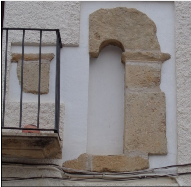
Fig. 2. Restos del ventanal bíforo de la primera planta.
