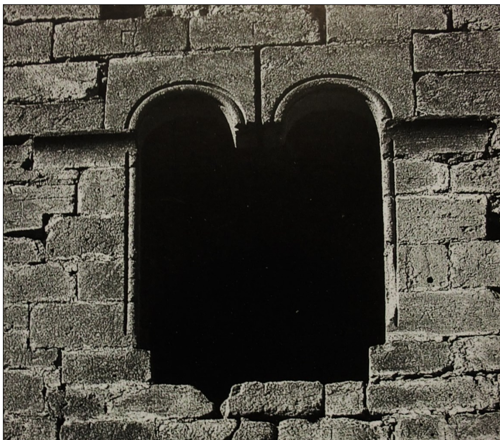
Fig. 7. Detalle de uno de los ventanales antes de la restauración ( Foto Centre d'Estudis Contestans).
