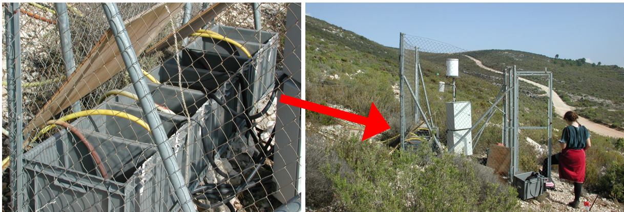
Figura 3.2.5 Recintos de las estaciones meteorológicas en Benidorm y Cocoll, observándose los depósitos de escorrentía en momentos de desborde de los colectores.
