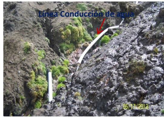
Foto 6.11. Línea de conducción del sistema de agua para EMAPA-Guaranda, expuesto a deslizamiento. UEB, 2013
