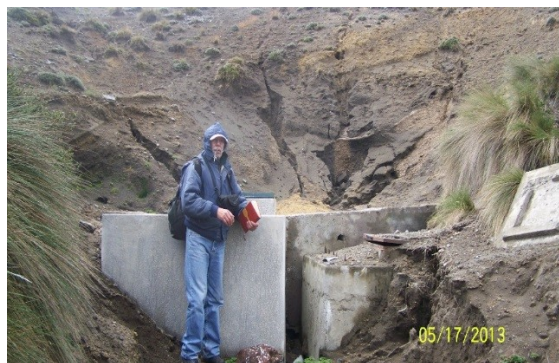
Foto 6.8 Tanques de captación del sistema de agua EMAPA-Guaranda, UEB, 2013
