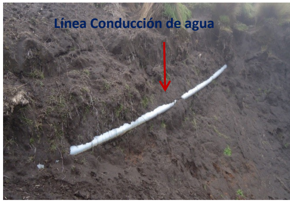
Foto 6.10. Línea de conducción del sistema de agua para EMAPA-Guaranda, expuesto a deslizamiento. UEB, 2013
