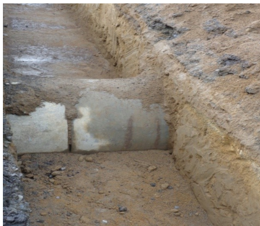
Foto 6.20: colector principal de la red de alcantarillado de Guaranda. Paucar, 2014.
