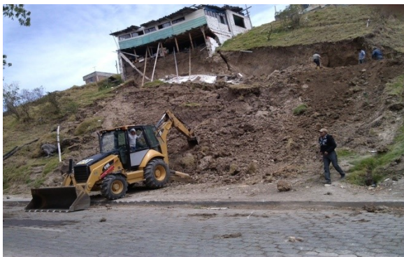
Foto 7.13: Edificación afectada por deslizamiento, localizada en zona de amenaza alta por problemas geotécnicos (calidad de suelo), sector Guanguliquin, fecha: 22/09/2013
