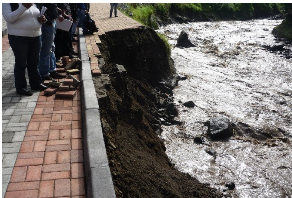
Foto 6.6: Afectaciones de crecidas del río Guaranda, sector Marcopamba (DPGR-B, 20/04/2012)
