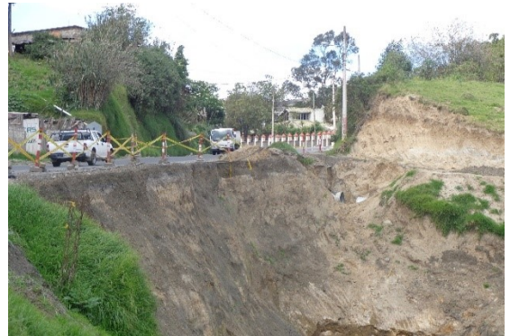
Foto 6.24 Elemento vial urbano, avenida principal Dr. Alfredo Noboa, afectada por deslizamiento. Paucar, 2013
