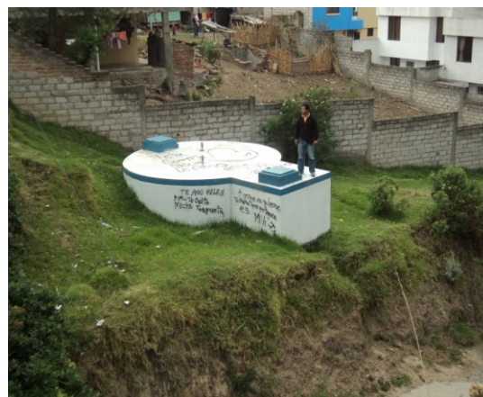
Foto 6.15 Tanque de distribución de agua, sector El Camal. Arellano (tesis UEB, 2013)
