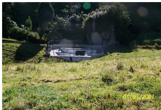
Foto 6.9. Tanques de captación del sistema de agua para JAAP-Guanujo. UEB, 2013
