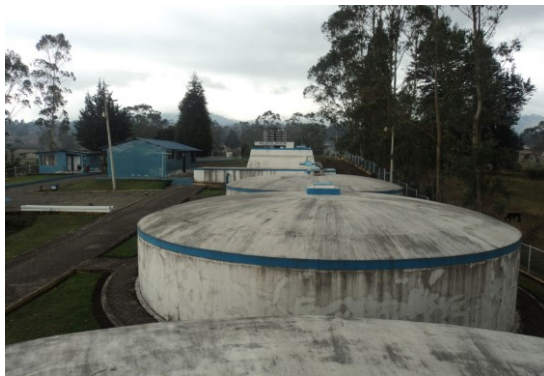
Foto 6.12. Tanque de tratamiento de agua, sector Chaquishca. Arellano (tesis UEB, 2013)
