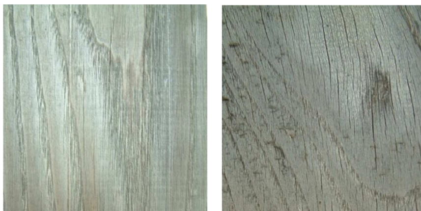
Figura 2.14. Izquierda, agrisado de la madera. Derecha, agrisado, pérdida de fibras y agrietamiento.
