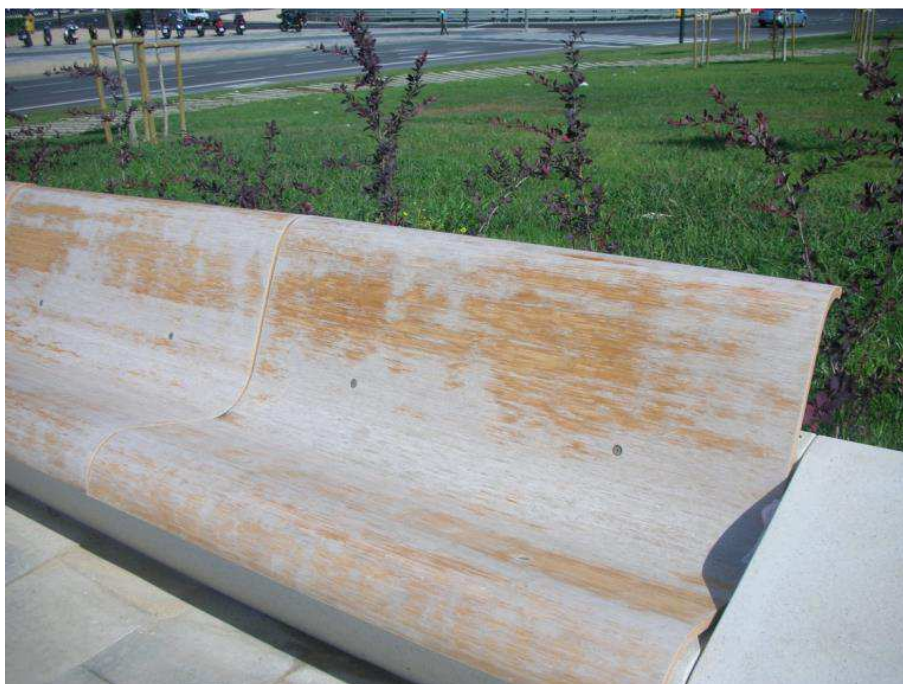
Figura 2.24. Defecto en mobiliario urbano, 24 bancos, tras seis meses de la instalación: fragilidad, agrietamiento y pérdida del recubrimiento.
