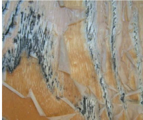
Agrietamiento, deslaminación, crecimiento de hongos.
