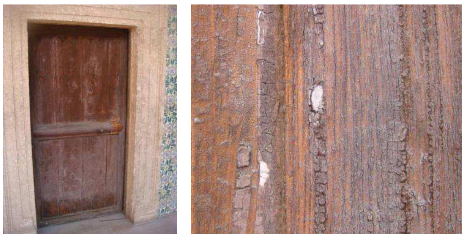
Figura 2.1. Izquierda, ejemplo de deterioro en todas las puertas de un claustro. Derecha, detalle del recubrimiento deteriorado con inicio de afectación del sustrato de madera.
