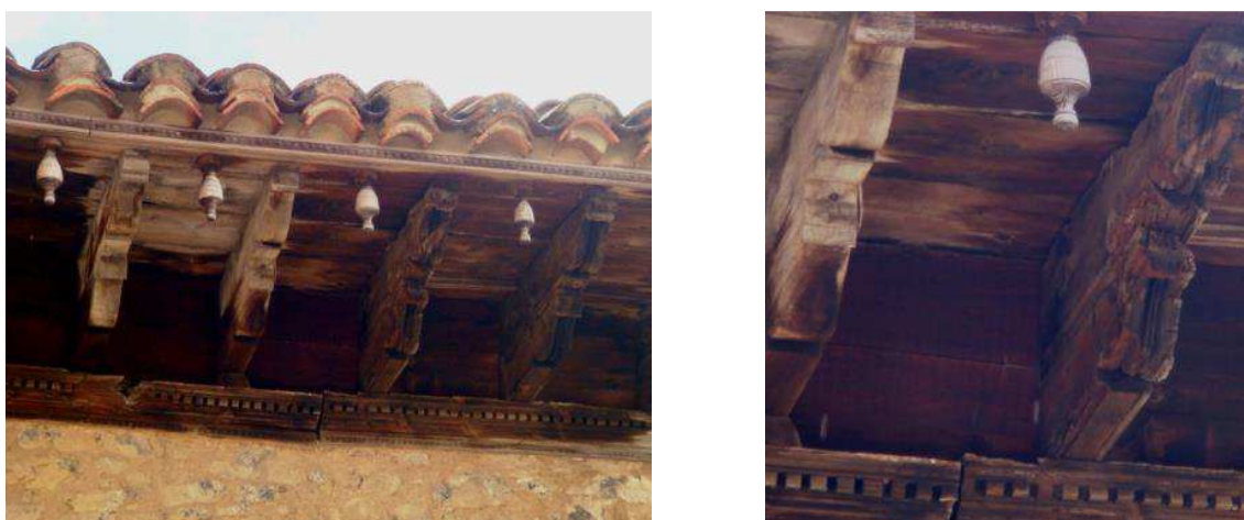
Figura 2.2. Deterioro primero del recubrimiento, y a continuación, afectación de la madera con zonas con erosión superficial del sustrato, con grietas, y otras en las que directamente ya se ha desprendido la madera.
