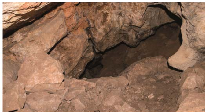
Fig. 4.240. Derrumbe producido al fondo de la galería.
