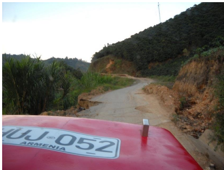
Foto 20. Inestabilidad geológica en la vía alterna La Celia - Pereira, 2011. Fuente: Propia.
