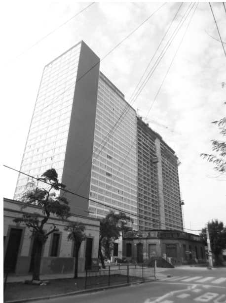
FIGURA 4 | Construcción de torres de oficinas de 30 pisos en las cercanías de la Maestranza de San Eugenio, sustituyendo la trama urbana tradicional de casas de clases obreras de una sola planta
