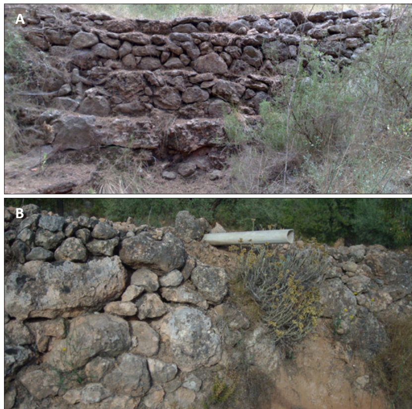
Figura 3.28: A-Salto en el punto de contacto de la acequia con el Barranco de Cabrera, B-Desagüe en una pared, en un punto donde se concentran flujos de agua en la superficie del bancale.
