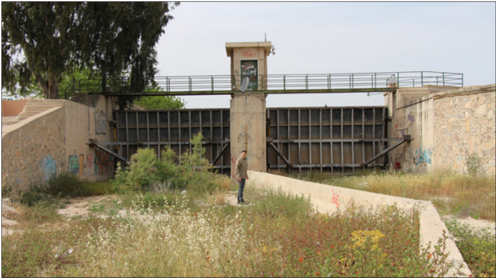
Figura 5.4: Compuertas actuales de los sangradores en el punto de arranque de la Rambla de Tiata (izquierda). El canal de la derecha, independiente, deriva las aguas hacia el sistema de Marchena (la Bóveda).
