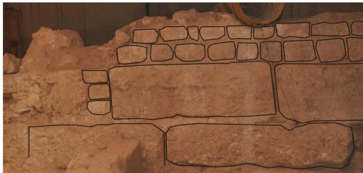
Fig. 8. Muro S de la estancia 1 de la Domus S- Palau de l'Almirall (VAL_12) ( Valentia ). En él se pueden apreciar las diferentes técnicas empleadas, posible reflejo de dos fases edilicias.
