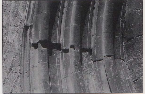
Detalle de la rotura de dovelas al ceder la sección exterior del muro del imafronte.
