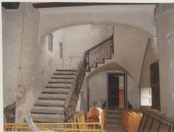
FOTO 1.- Escala d'accés al pis superior on s'aprecia l'arc de guix que impedeix que des d'eixa posició es pugua veure la pintura del sostre de l'escala.
