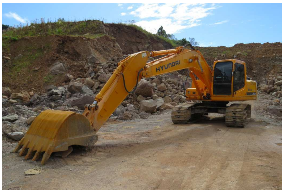
Figura 45 – Foto da mineração de siltito localizada em Lauro Müller/SC. Jazida pertencente a Rio do Rastro Mineração /Tecnoclay A autora: Keity Kristiny Vieira Isoppo, 2017.
