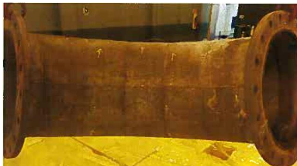
Figura 7.4. Imagen del conducto de ventilación.
