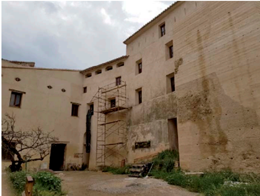
Fig. 4.- Fortificación almohade (siglo XII) donde, en planta superior, se construyó la primitiva iglesia parroquial (siglo XIII), reconvertida después en dos estancias superpuestas, la inferior posible sala de honor del palacio señorial (siglo XV). A la izquierda, adición arquitectónica del siglo XIX. Fotografía Juan F. Díaz Egío.
