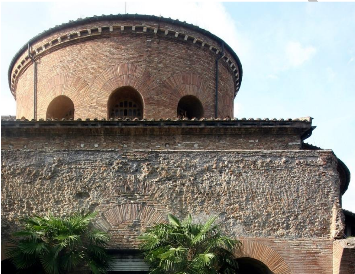
En aquesta foto es veu la tècnica constructiva d'opus testaceum , és a dir, de nucli de formigó amb capes de rajola exteriors.
