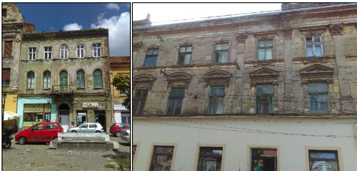
Foto.36. Clădiri din Piața Traian aflate în stare de degradare
