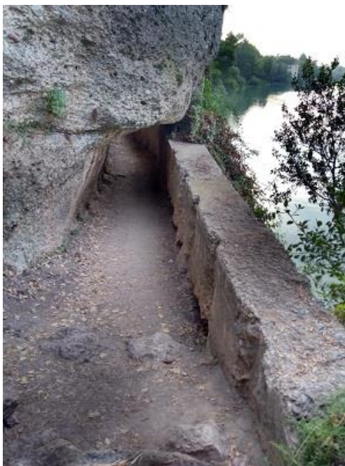
Imatge 67. Tram de la sèquia de les argamasses amb marques de fustes als murs, emprats per a la tàpia. 798
