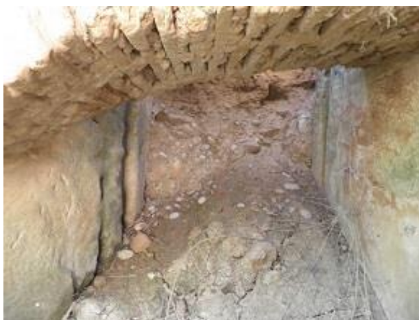
Imatge 76. Detall interior del portalet que permetia passar l'aigua fins a l'assut de Borriana. 872
