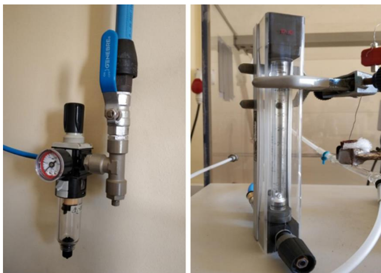
Figura 20. Fotografía de la llave de paso, el manorreductor y el rotámetro empleado en la instalación del aire comprimido.
