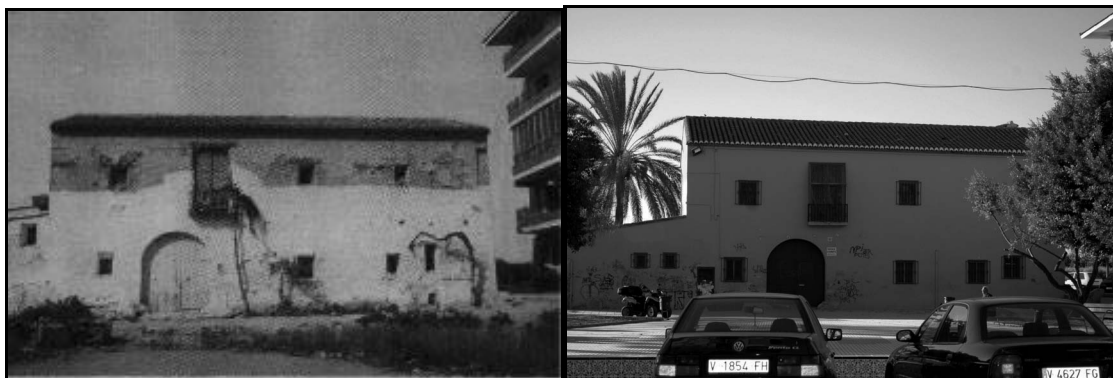
Figura 52: L'Alqueria de Sòria en 1981, ubicada junt al barri d'Orba a Alfafar. Sembla hui encara estar en estat d'abandonament. Fotografies: VILA (dir.), 1981 i Luis del Romero.
