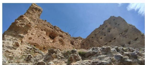
Interior de la torre des del buit deixat per la cara sud. Interior de la torre des del vacío dejado por la cara sur.
