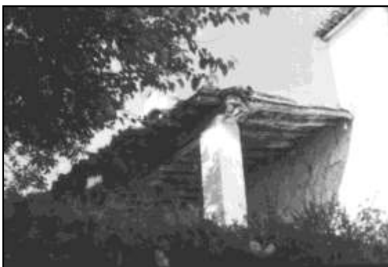
Figura 70. Antigua mezquita de Benaença. Siglo XIV. Actual ermita de la Santa Cruz, Chelva (Valencia). Mario Guillamón Vidal (F391-060), 1960-1982. Biblioteca Valenciana Nicolau Primitiu (València) ©.
