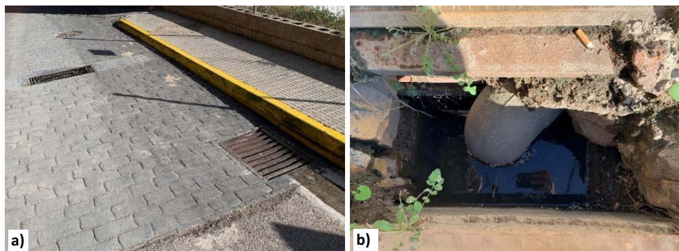
Figura 42. a) Situación de los imbornales del término municipal de Sueras correspondientes a los puntos de muestreo SUE1 y SUE6. b) Interior del imbornal correspondiente al punto de muestreo SUE1.
