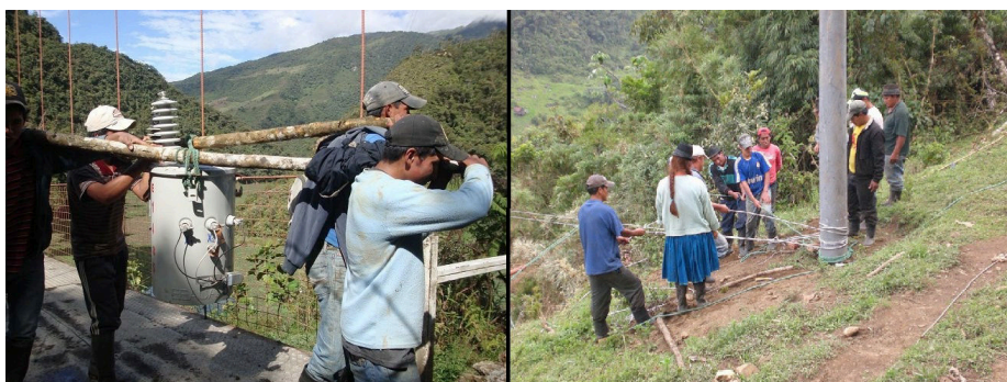
Imagen 1. Trabajo comunitario para la construcción de obras de electrificación en zonas de difícil acceso
